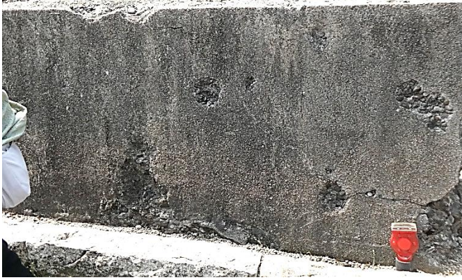
愛知時計電機本社の東にある堀川沿いにある被爆堤防 悲惨だった熱田空襲の爆撃痕が残っている。
