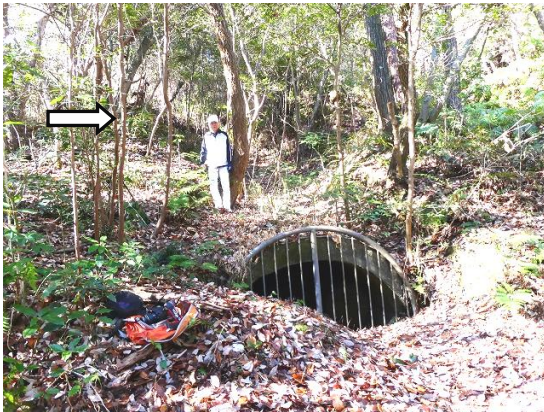
⑤第1区第7坑と陥没溝
