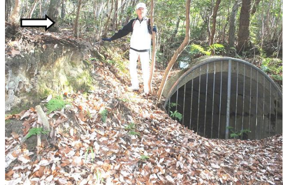
④第2区第10坑と陥没溝
